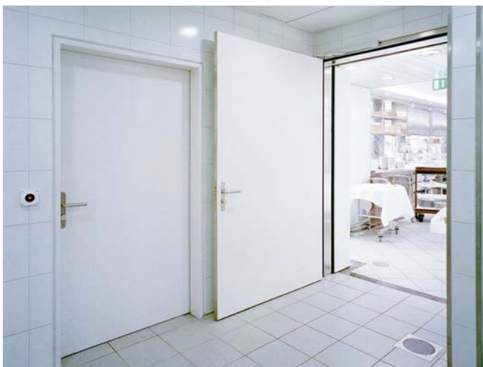
! Häufig kommen in Krankenhäusern überbreite Türen zum Einsatz, die beispielsweise auch feuchtebeständig sein müssen.
