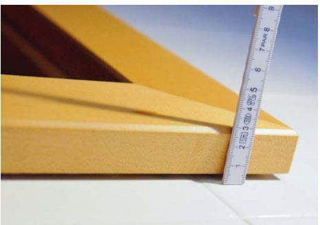
/ Ungleichmäßige Spalte zwischen Bekleidungen und Wandoberfläche. Bis zu 7 mm Spalt sind zu tolerieren.
