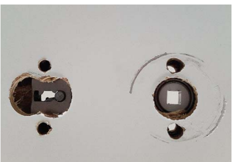
/ Sind die Rosetten-Bohrungen nicht genau ausgeführt, können Rosetten an der Oberfläche schaden.
